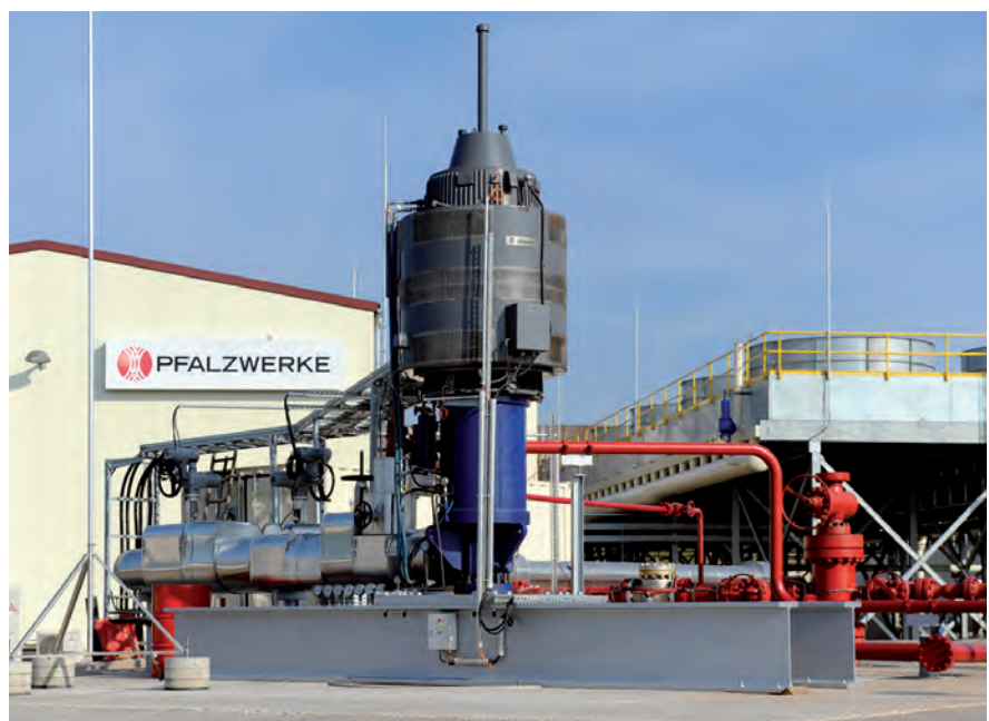
Geothermieanlage in Insheim (©Pfalzwerke Geofuture)
