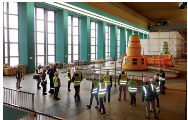
Turbine des Wasserkraftwerkes der EDF in Vogelgrün (©TRION-climate e.V.)
