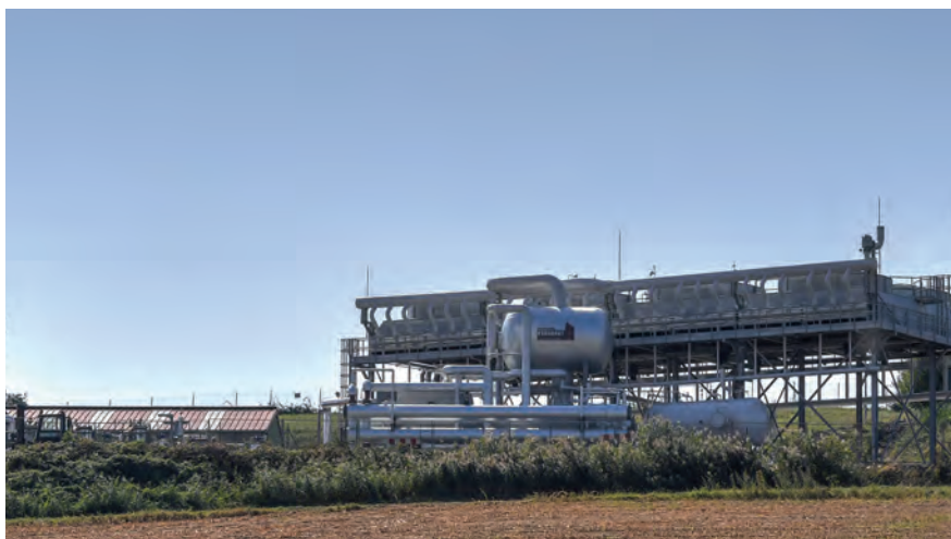
Centrale géothermique à Soultz-sous-Forêts (©Electricité de Strasbourg)
