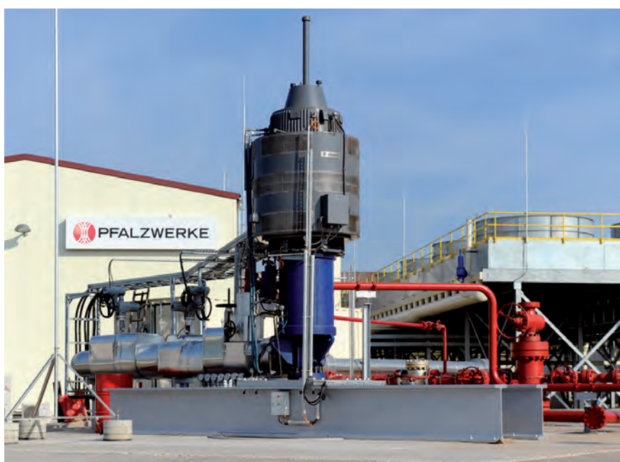
Centrale géothermique à Insheim (©Pfalzwerke Geofuture)
